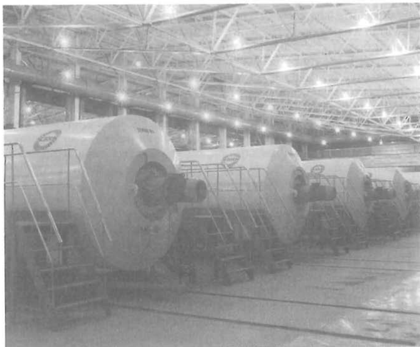
Установка термостатирования газодиффузионного завода
