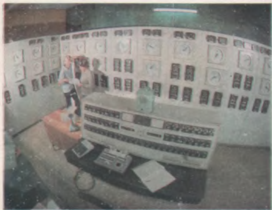
Главный энергетик фабрики В. Г. Иванов и флотатор Л. К. Залевская у пульта управления процессом флотации
