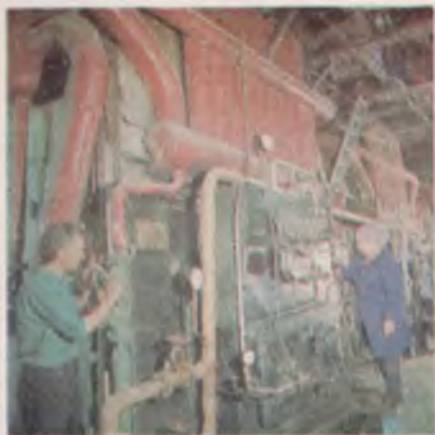
Промышленные котельные объединения переведены на жидкое топливо. Котельные агрегаты работают в автоматическом режиме
