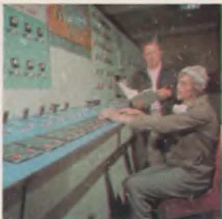
Мастер свинцового завода Ю. В. Синякин (стоит) у пульта автоматизированного управления системой фильтров
