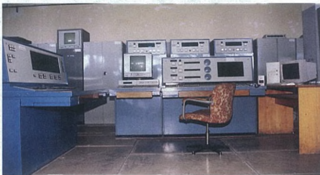
Демонтированная аппаратура комплекса
