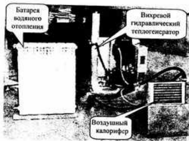
Рисунок 6.17 – Термогенератор ТМГ-3, подключенный к батареем водяного отопления и воздушному калориферу
