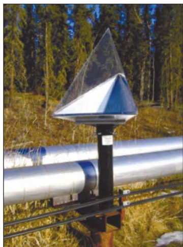
Рисунок 3.1. Угловый отражатель, установленный на опоре надземного трубопровода
