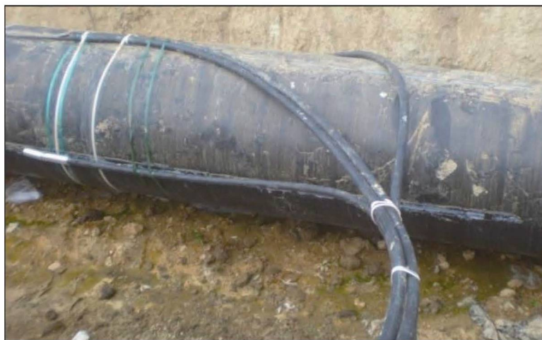
Рисунок 4.11. Волоконно-оптические сенсоры, установленные на магистральном трубопроводе «Сахалин–Хабаровск–Владивосток»
