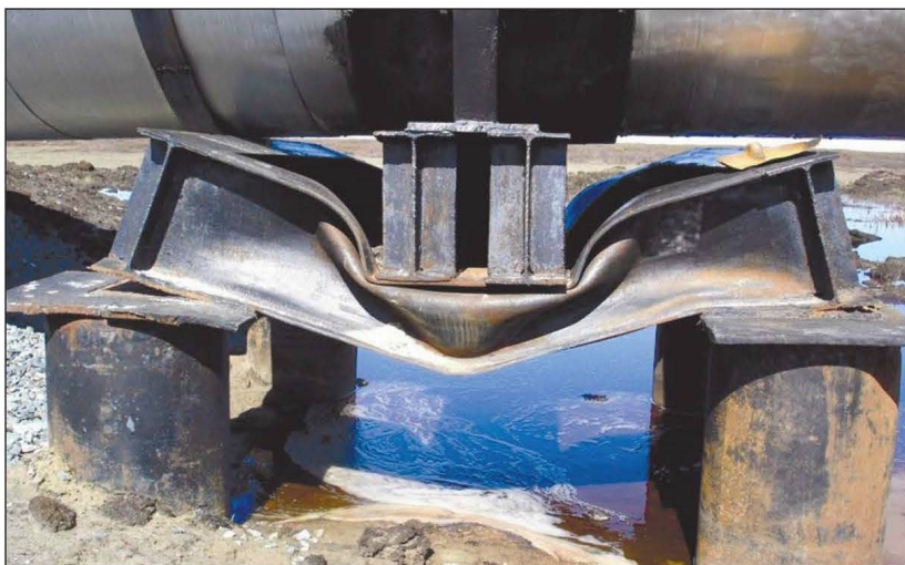
Рисунок 1.11. Деформация ростверков свайных опор надземного трубопровода при воздействии пучения грунтов
