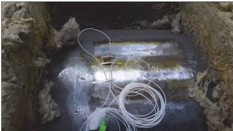
Рисунок 4.20. Датчик подсистемы мониторинга температуры. Фотография выполнена в процессе монтажа
