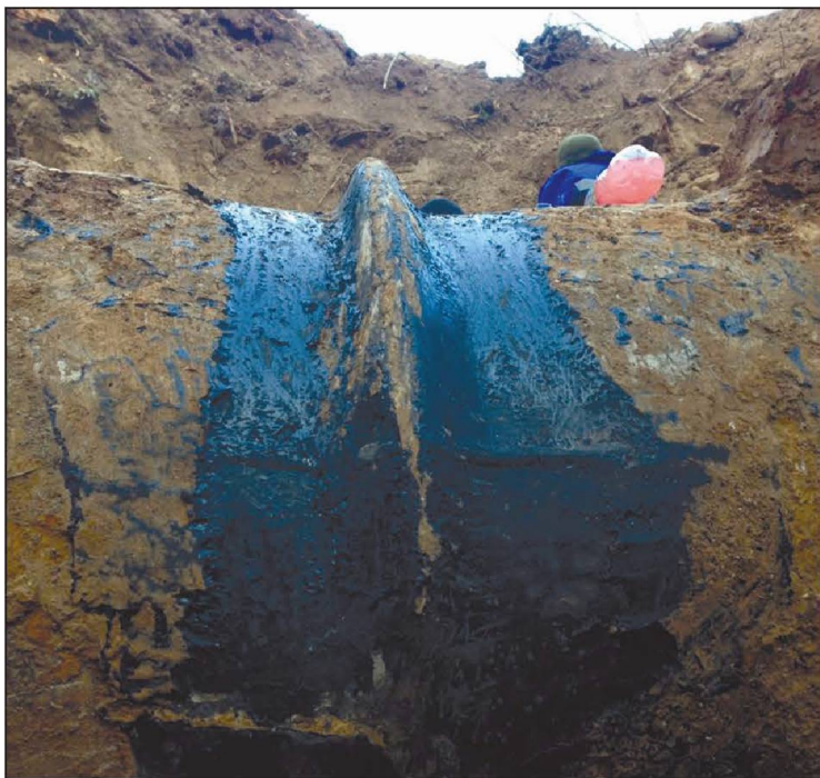
Рисунок 1.9. Гофр наружный высотой 70 мм на газопроводе Ду 1400
