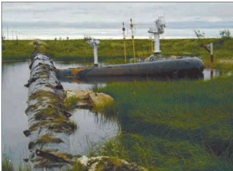
Рисунок 1.12. Изгиб трубопровода вследствие термоареста
