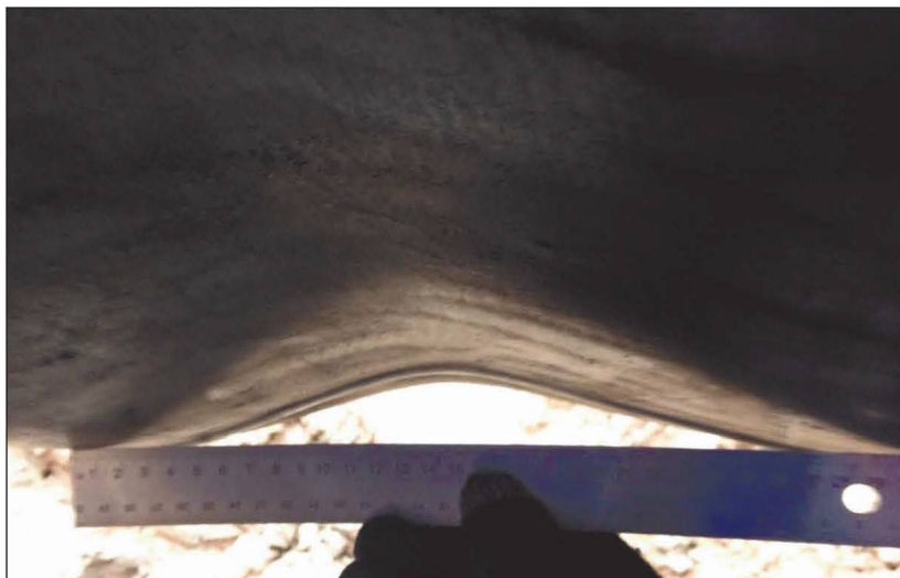
Рисунок 1.10. Гофр внутренний глубиной 60 мм на газопроводе Ду 1400
