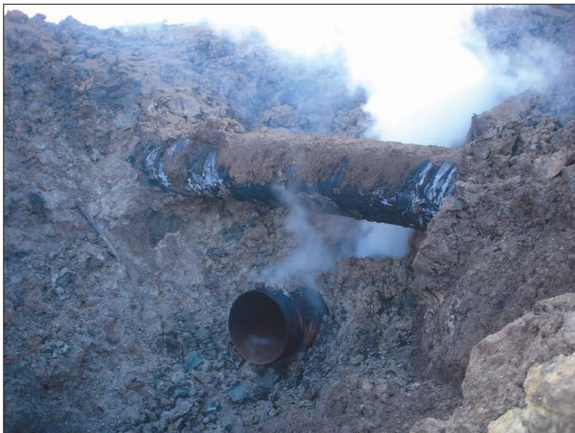
Рисунок 4.13. Последствия аварии на пересечении газопроводов
