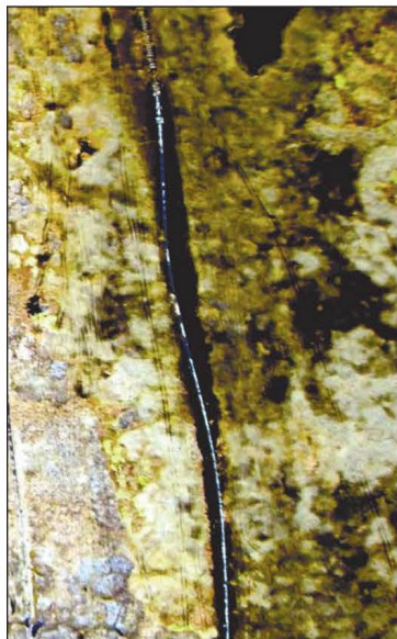
Рисунок 3.8. Участок трубопровода с потерей устойчивости из-за высокого уровня продольных сжимающих напряжений [45]
