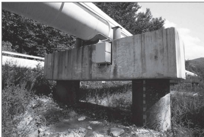
Рисунок 4.10. Внешний вид блока инклинометров, установленного на опоре магистрального нефтепровода
